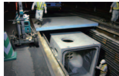
桁が無いことで、構造物の設置作業が早まります。 (長崎県長崎市 国道206号線)
