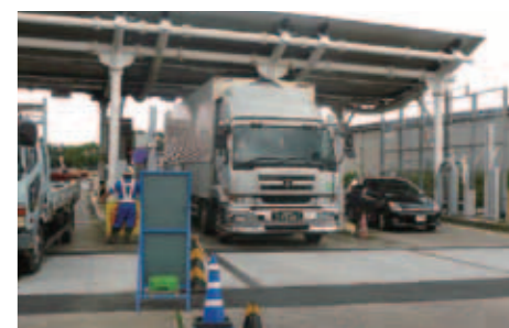
土被りの浅い構造物でも道路面とフラットになるため、すり付けが不要です。 (滋賀県彦根市 名神高速道路)
